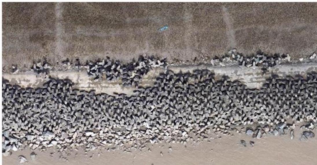
图 2.4-5 修复前金汇塘东段岸段消浪坝现状
