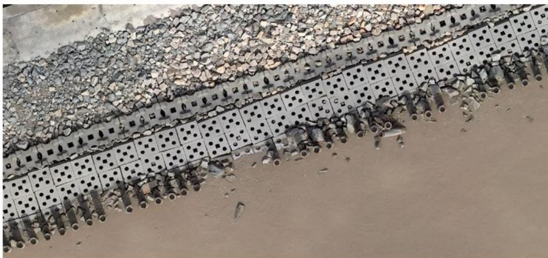
图 2.4-7 修复前华电灰坝东圈围大堤岸段消浪坝现状
