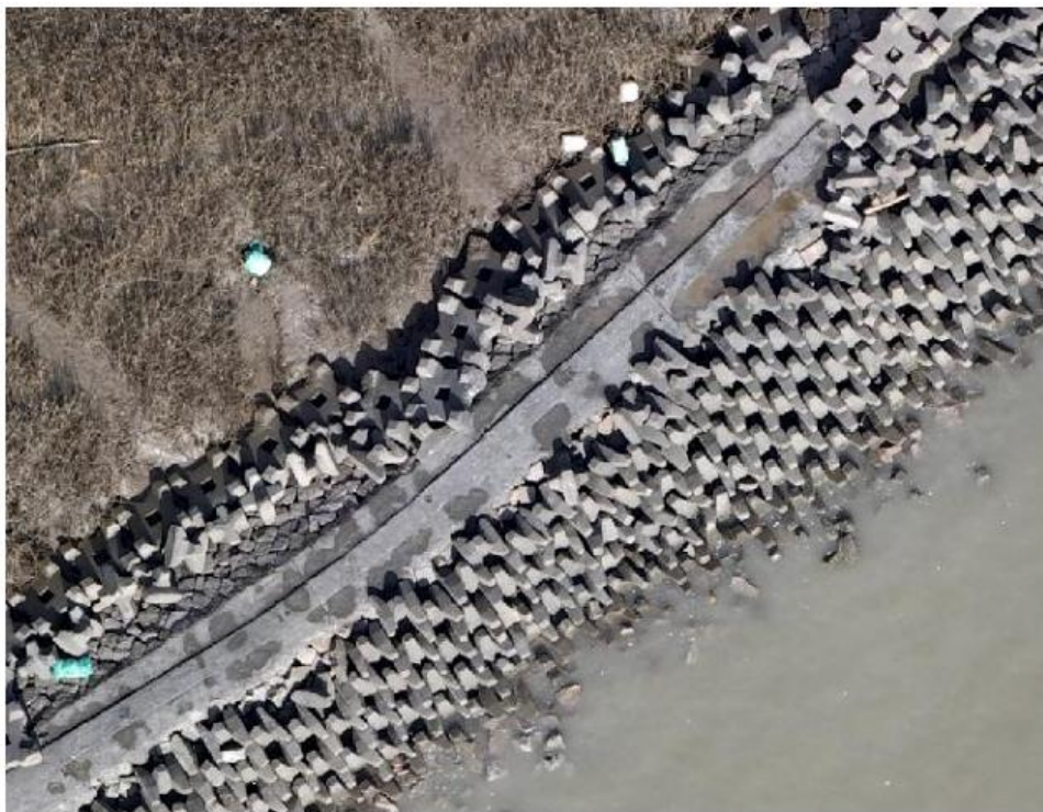
图 2.4-3 修复前海水塘岸段消浪坝现状
