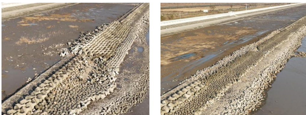
图2.2-3 消浪坝破损现状
