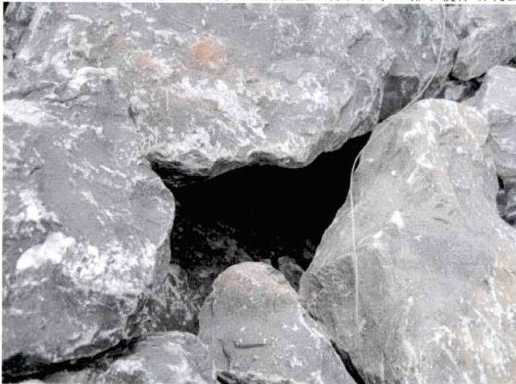
质量管理图 1-2 排水棱体干砌块石砌筑质量不符合要求，干砌块石架空
